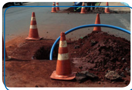
Substituição de 35 quilômetros de redes em Campos Elíseos, Jardim São Luiz, Sumarezinho e Vila Tibério, entre outros
