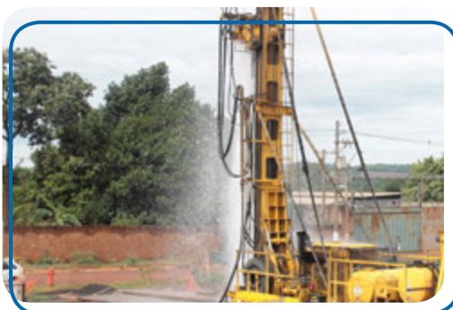
Novo poço do Complexo Ribeirão Verde (90 mil pessoas beneficiadas), em fase de testes
